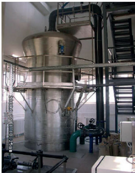
Rys.22.9. Instalacja w Dejtar
