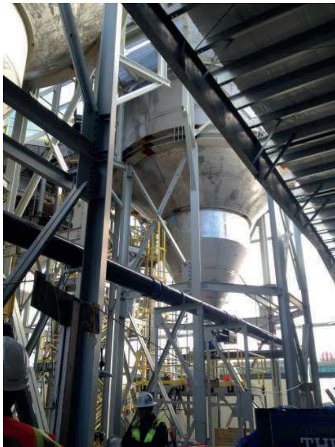
Rys. 21.1. Instalacja do odzysku fosforu na oczyszczalni „Stickney” w Chicago
