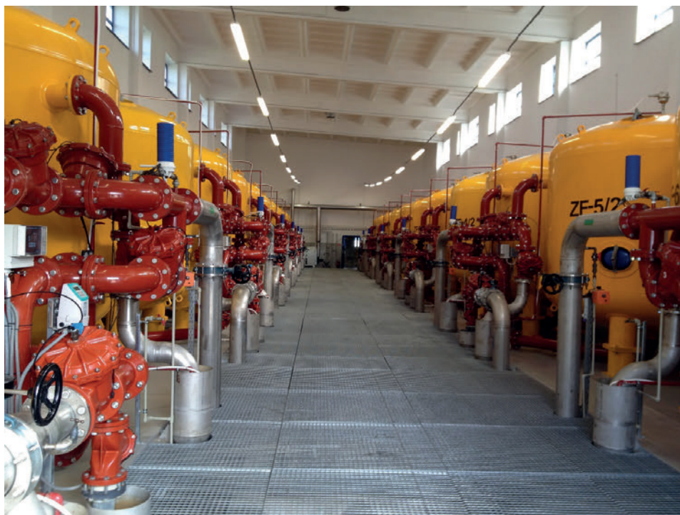
Rys. 28. Stacja Uzdatniania Wody w Gdyni-Reda
