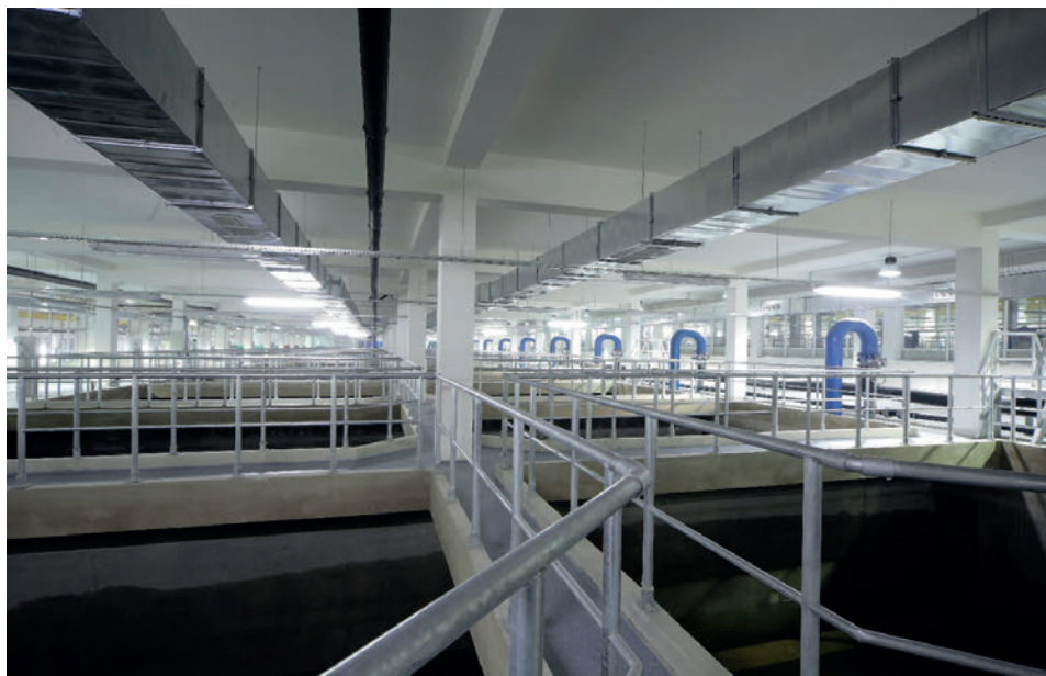
Rys. 32. Stacja Uzdatniania Wody w Moskwie
