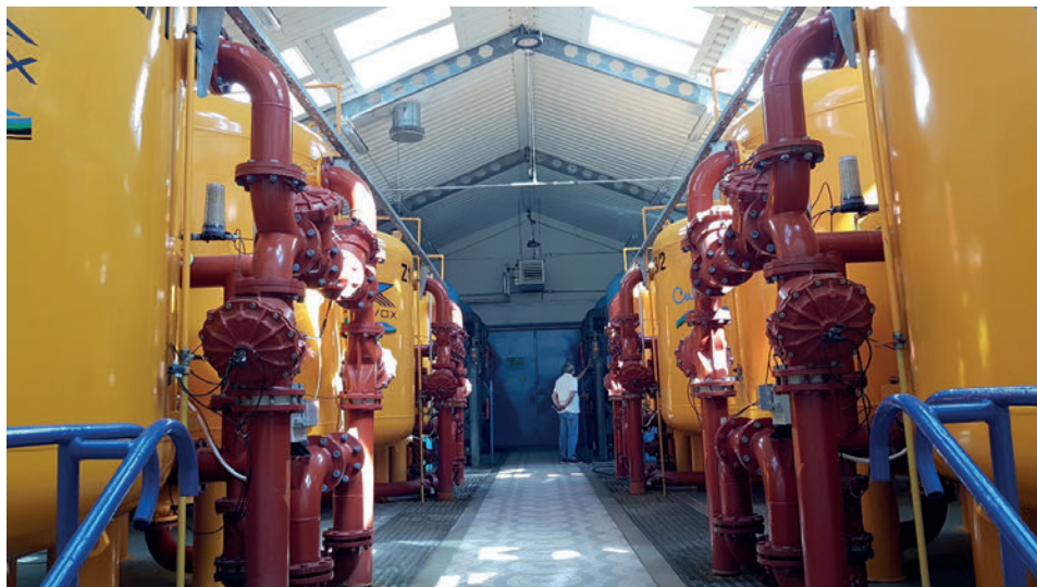
Rys. 27. Stacja Uzdatniania Wody w Iławie
