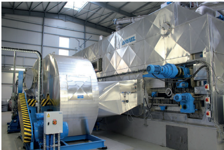
Rys. 33. Suszarnia osadów ściekowych w Radomiu
