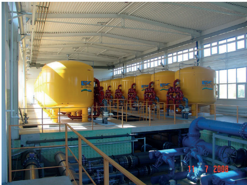
Rys. 29. Stacja Uzdatniania Wody w Radomiu
