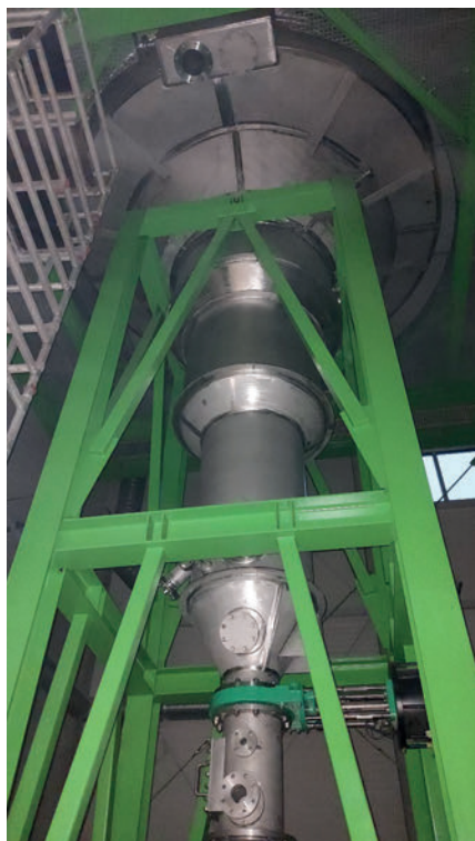
Rys. 36. Reaktor odzysku substancji biogennej w Jarocinie
